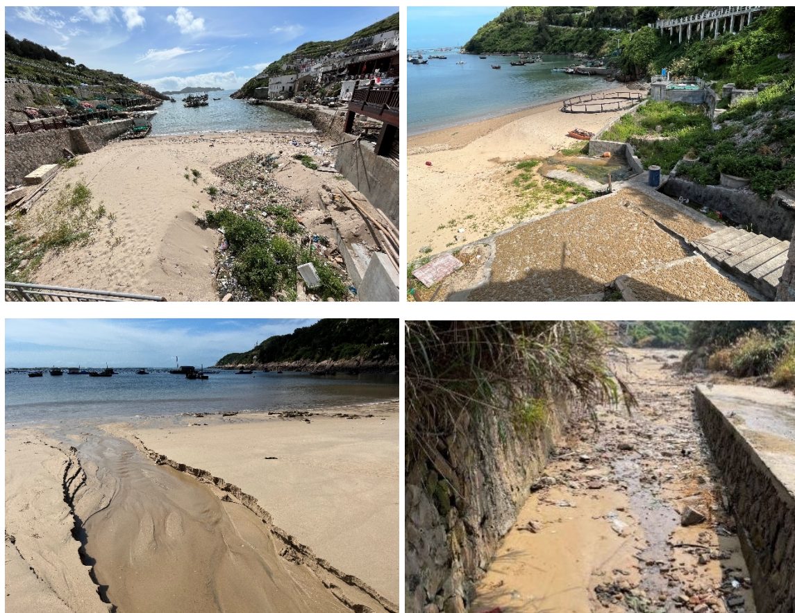
图2.3-13 沙滩排水口直排导致沙滩侵蚀
