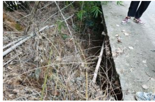
图2 路基严重破坏（沙岗村-官山村）
