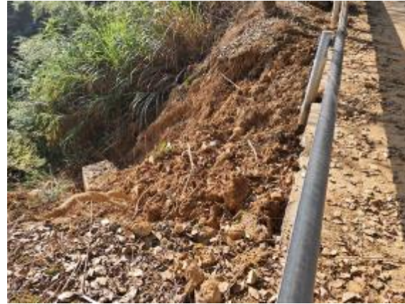
图1 路基外侧塌方（雅村-莲花村）
