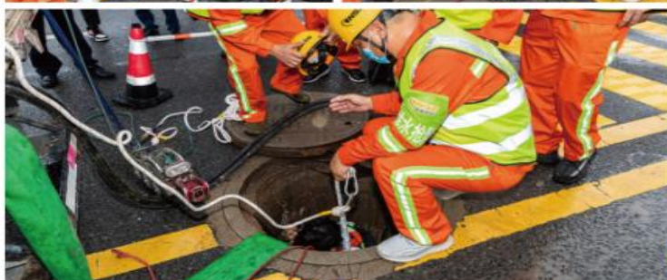
下井排除险情
